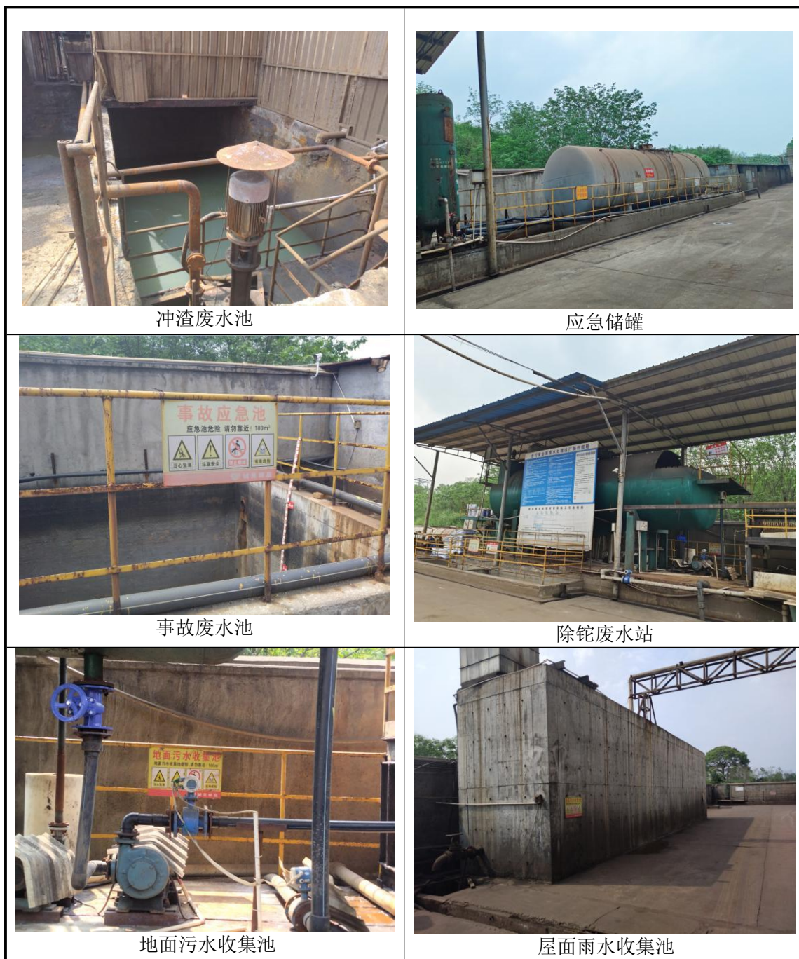
图 3.4-2 现有厂区废水收集和処理设施
