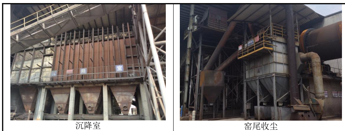
图3.4-2 现有厂区废气处理设施
