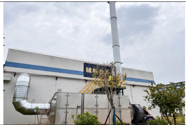
活性炭吸附+排气筒
