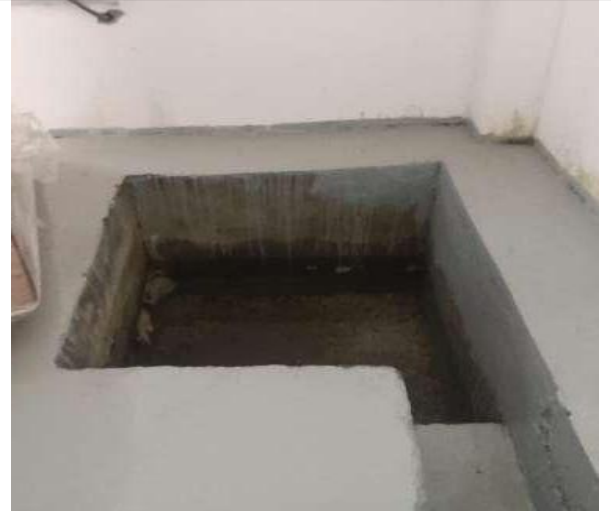
危废间事故池
