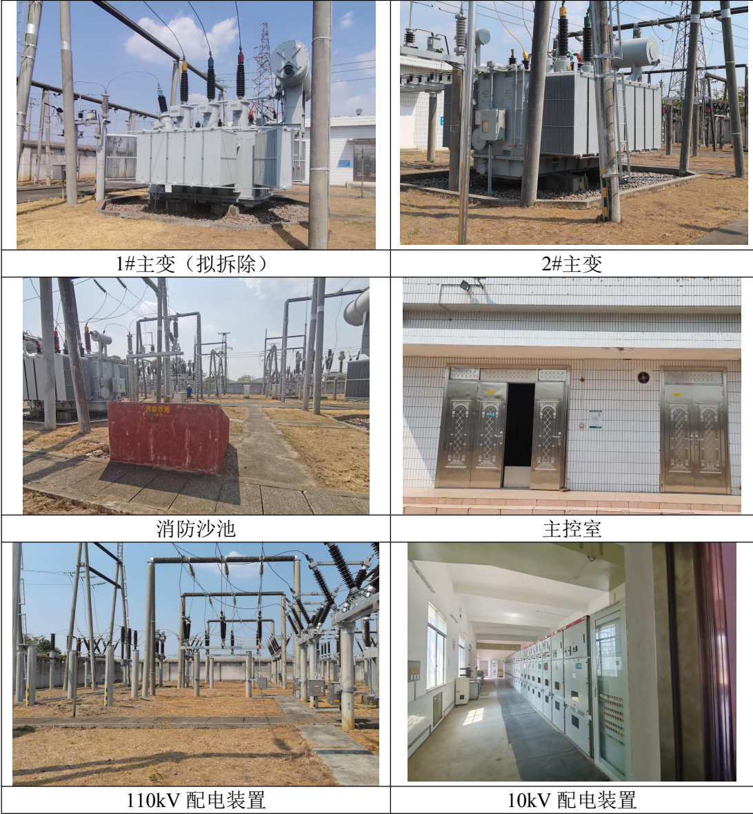
图 2-1 变电站站内环境现状
